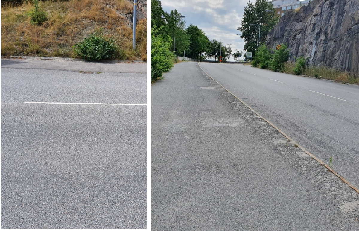
Figur 6. Planområdet lutar kraftigt men dagvatten tas endast in i ledningsnätet med små brunnar i sidan av vägen.
